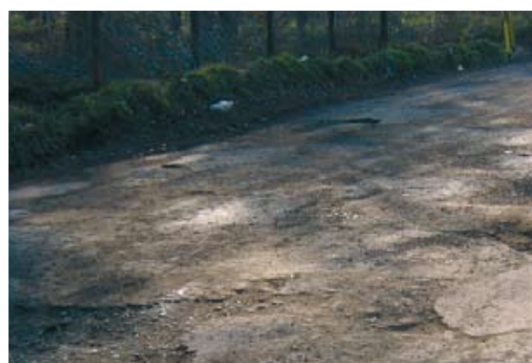
ул. „Явор“ преди ремонта
